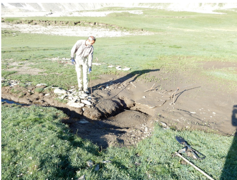
La perte est bouchée (photo Guy)
